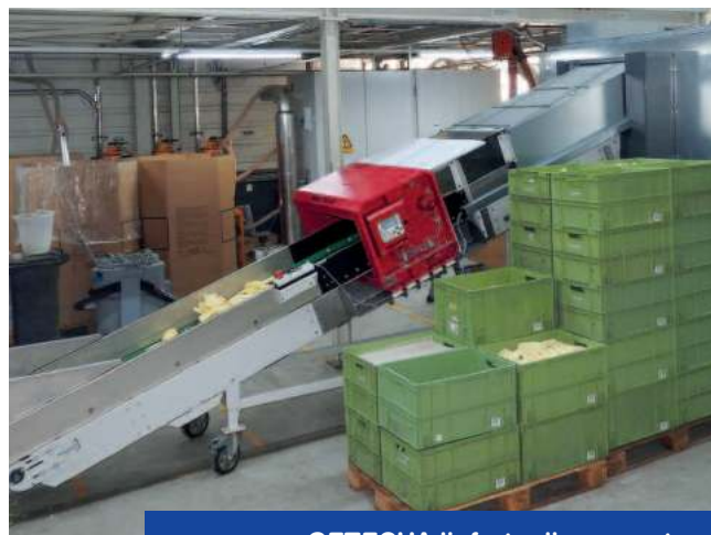
GETECHA lieferte die gesamte Prozessstufe der Vorzerkleinerung der neuen Recyclinganlage von Hansgrohe, bestehend aus Schneidmühle, Förderbandsystem sowie Entstaubungs- und Abluftsystem (Bild: Getecha)
